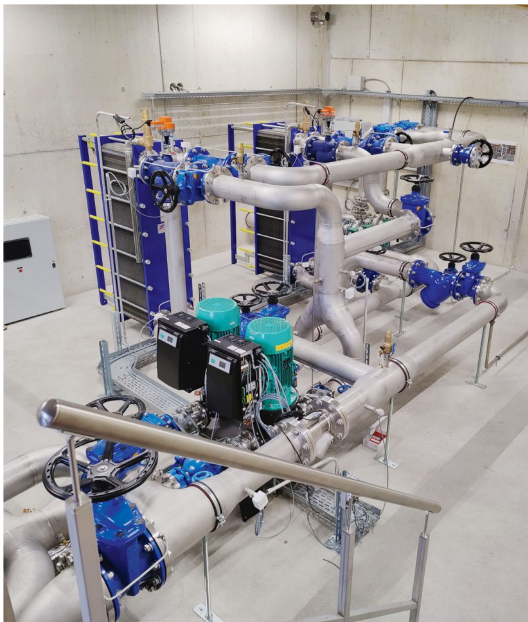
L'échangeur de chaleur du réservoir des Philosophes. LDD
